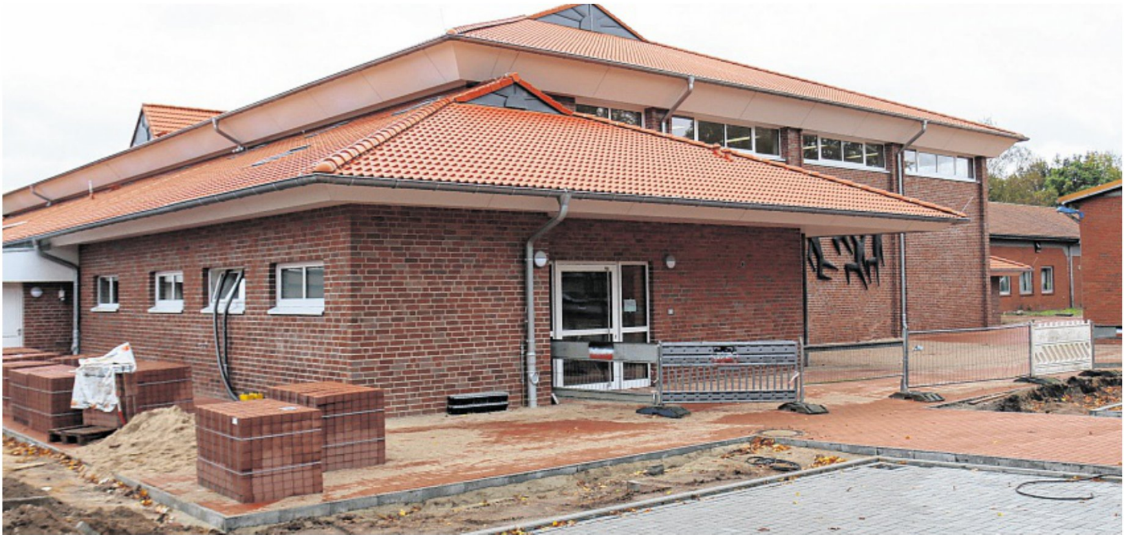
Von außen sieht die neue Wasbeker Turnhalle fast fertig aus. Doch es gibt Probleme wegen eines Bohrlochs in einer Wasserleitung.
