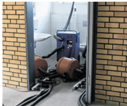
In der neuen Wasbeker Turnhalle laufen die Trocknungsgeräte, da ein Wasserrohr ein Leck hatte.
