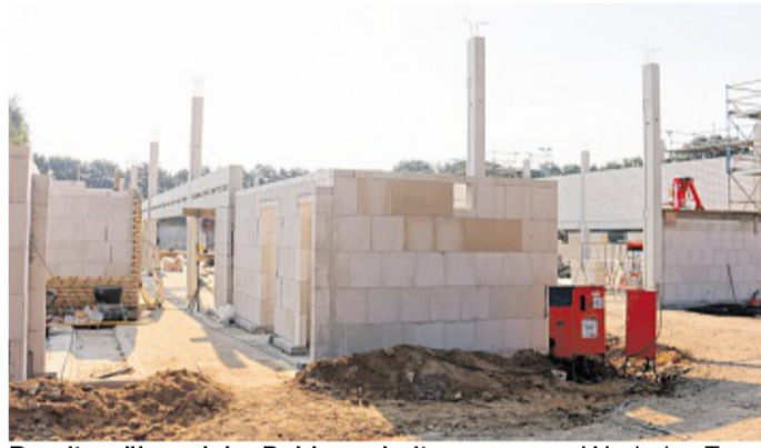
Bereits während der Rohbauarbeiten zur neuen Wasbeker Turnhalle war zu erkennen, dass hier ein moderner Bau entsteht, der zukünftig den Sportlern viel Freude bereiten wird.
